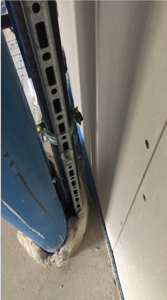
Hulpconstructie (flamcorail), met wol-afdichting
